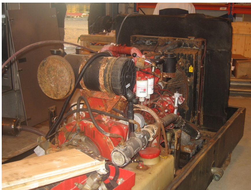
Illustrasjon 6.1: Dårlig vedlikeholdt Diesel notvasker
